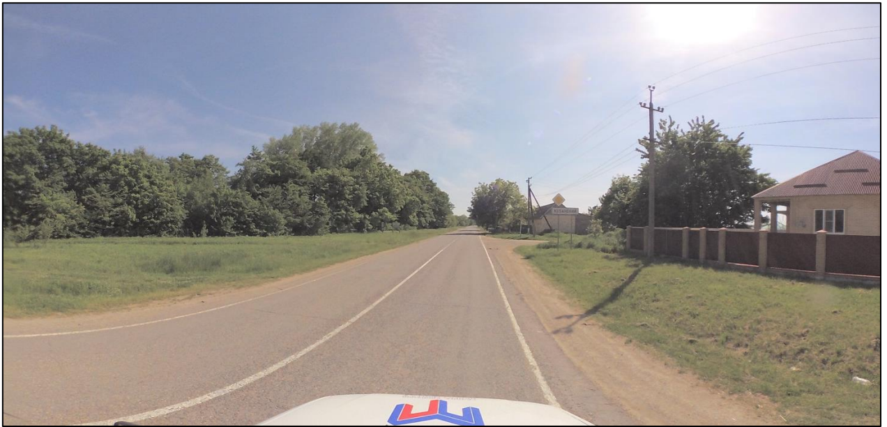
Рисунок 1.4.6 – Состояние дорожного покрытия а/д 03 ОП РЗ 03К-141 «ст-ца Пшехская – х. Кубанский» на момент обследования
