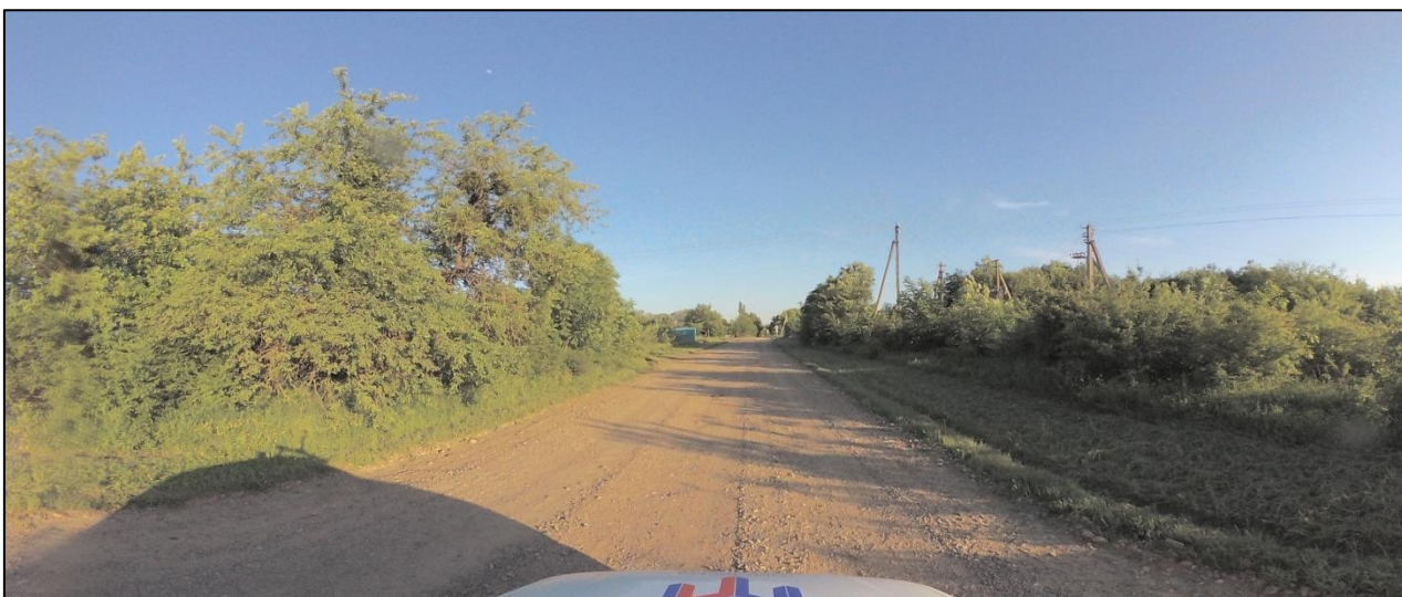
Рисунок 1.4.4 – Состояние дорожного покрытия 03 ОП РЗ 03К-133 «ст-ца Бжедуховская – ст-ца Октябрьская – х. Новогурийский» на момент обследования
