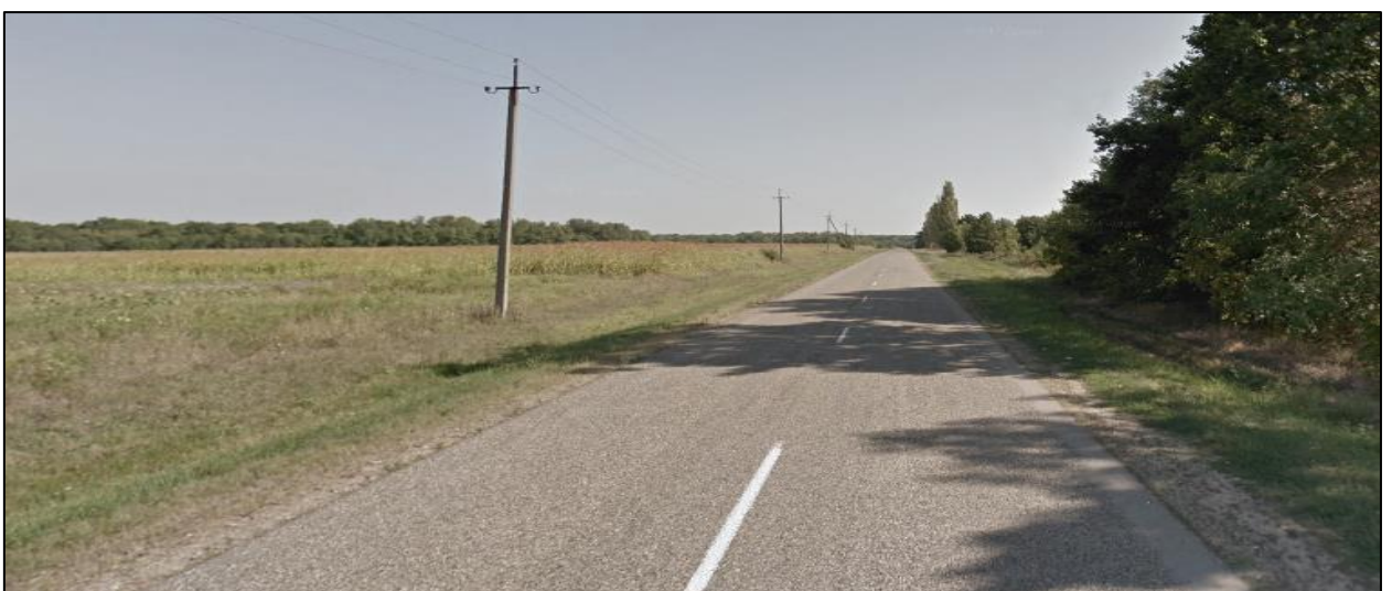
Рисунок 1.4.5 – Состояние дорожного покрытия а/д 03 ОП РЗ 03К-138 «Подъезд к ж.-д. ст. Комсомольская» на момент обследования
