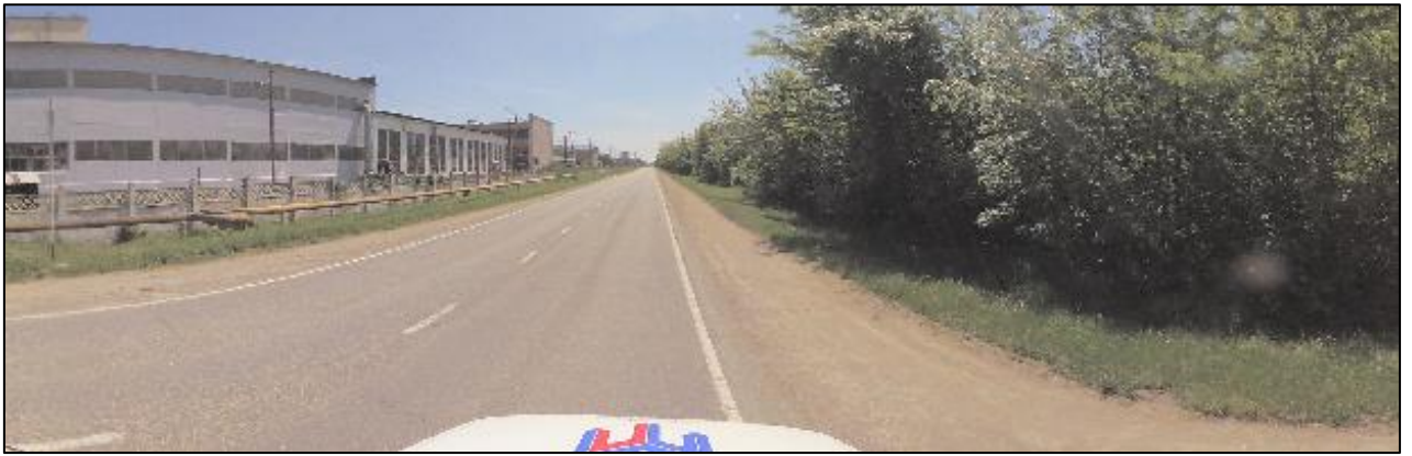
Рисунок 1.4.4 – Состояние дорожного покрытия 03 ОП РЗ 03К-038 «г. Белореченск – ст-ца Ханская» на момент обследования
