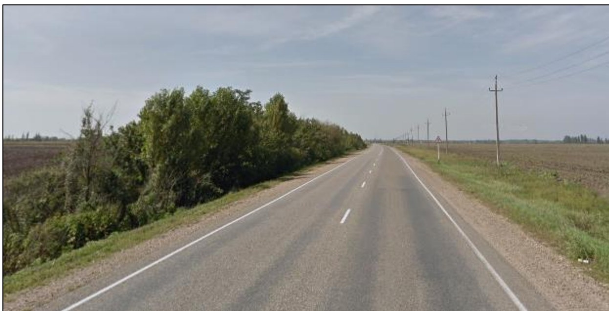
Рисунок 1.4.5 – Состояние дорожного покрытия а/д 03 ОП РЗ 03Н-139 «с. Великовечное – с. Новоалексеевское» на момент обследования
