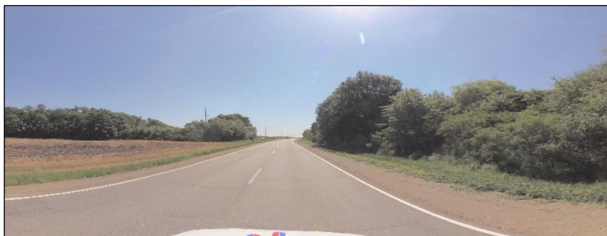
Рисунок 1.4.5 – Состояние дорожного покрытия 03 ОП РЗ 03Н–134 «г. Белореченск – п. Нижневеденеевский» на момент обследования
