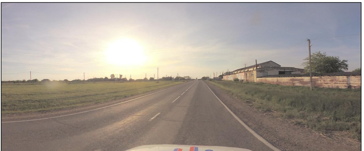
Рисунок 1.4.3 – Состояние дорожного покрытия 03 ОП РЗ 03К-073 «ст-ца Гурийская – ст-ца Черниговская – ст-ца Рязанская» на момент обследования
