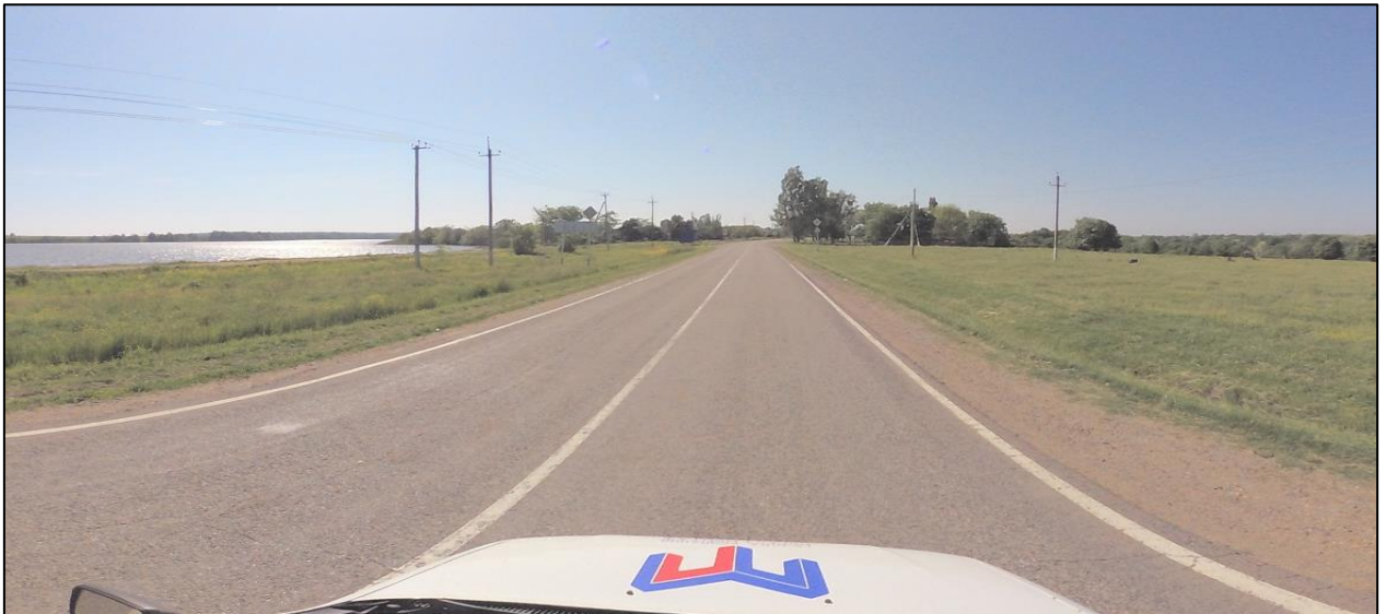
Рисунок 1.4.2 – Состояние дорожного покрытия 03 ОП МЗ 03Н-136 «п. Мирный – ст-ца Бжедуховская – х. Беляевский» на момент обследования
