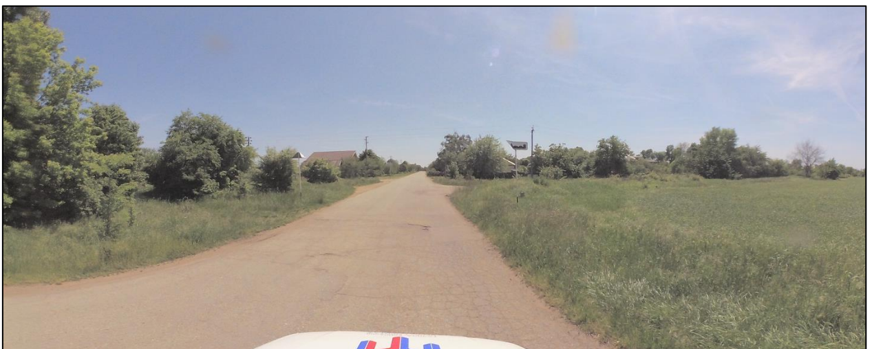
Рисунок 1.4.6 – Состояние дорожного покрытия а/д 03 ОП РЗ 03К–142 «Подъезд к п. Восточный» на момент обследования
